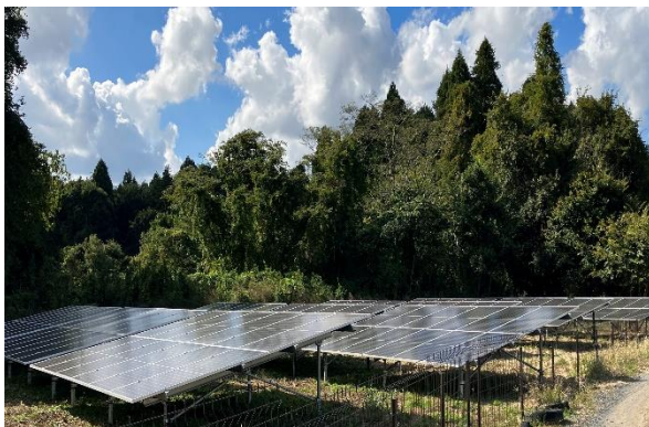
供給元：JERA 太陽光発電所
